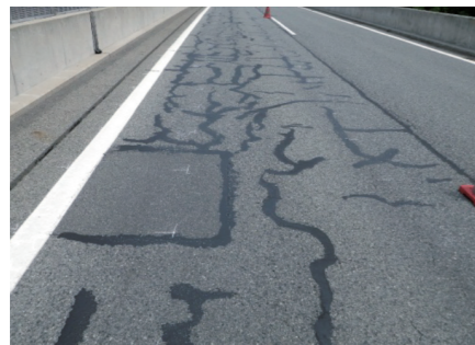
舗装路面の変状
