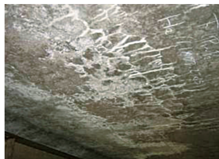
床版下面のひび割れと漏水
