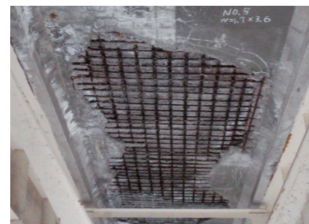
床版下面コンクリートの剥離
