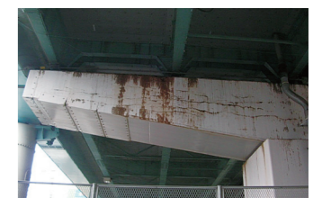
ひび割れが進んだ橋脚
