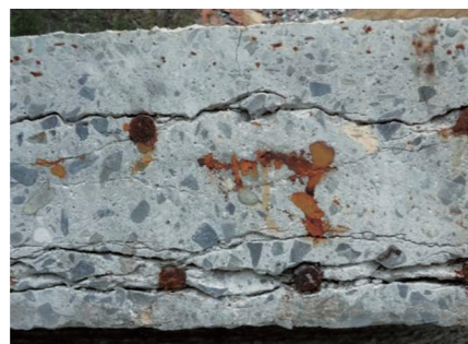
床版内部の水平ひび割れ
