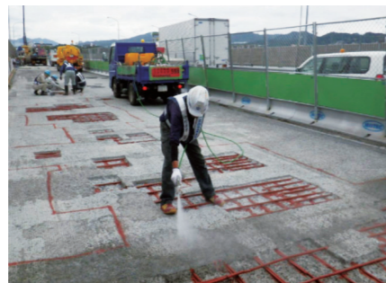
床版上面コンクリートの浮き
