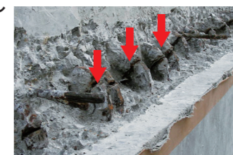
コンクリート内部の破断した鉄筋
