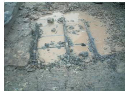
床版上面コンクリートの土砂化
