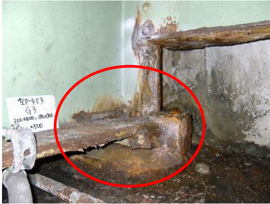
鋼桁端部の腐食による断面減少
