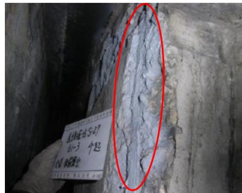
主桁の鉄筋露出
