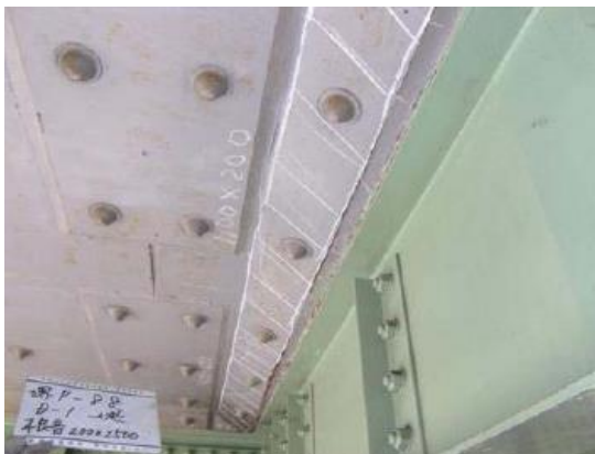
鋼板補強されたRC床版端部で不良音を確認
