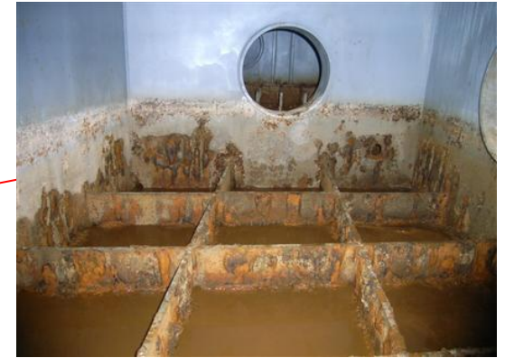
鋼製フーチング内部腐食状況
