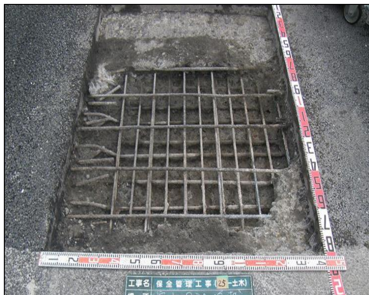
床版コンクリートの陥没
