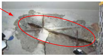
PCケーブル部の腐食
