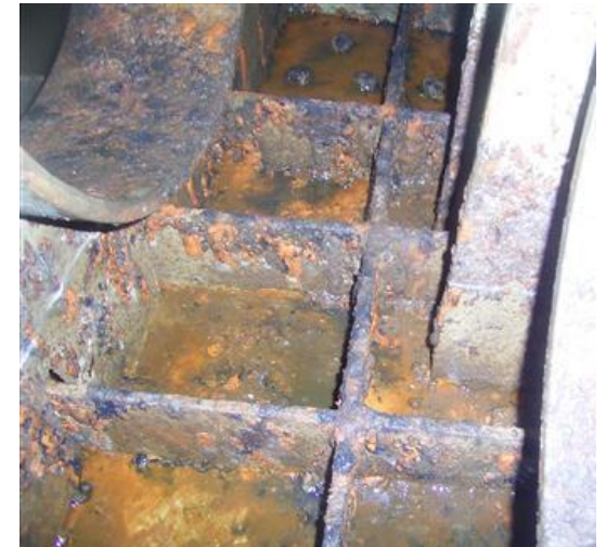
腐食による断面減少
