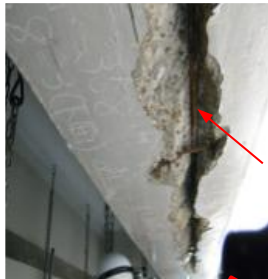
PCケーブル部の腐食による桁下面コンクリートのき裂
