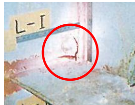
主桁横桁交差部のき裂
