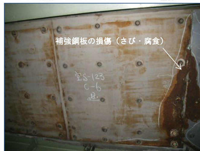
補強鋼板(鉄筋コンクリート床版下面)の損傷
