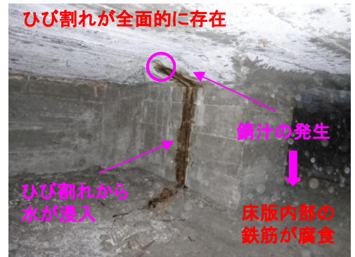
箱桁内部の損傷状況
