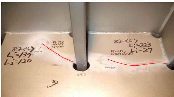
スカーラップ部の疲労き裂
