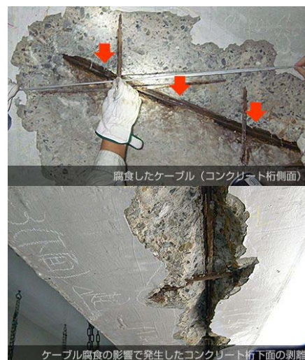
写真-1 PC 桁の損傷状況
