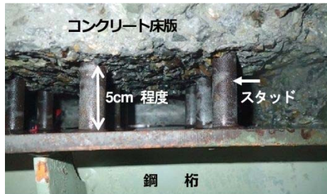
写真-1 スタッドの露出状況
