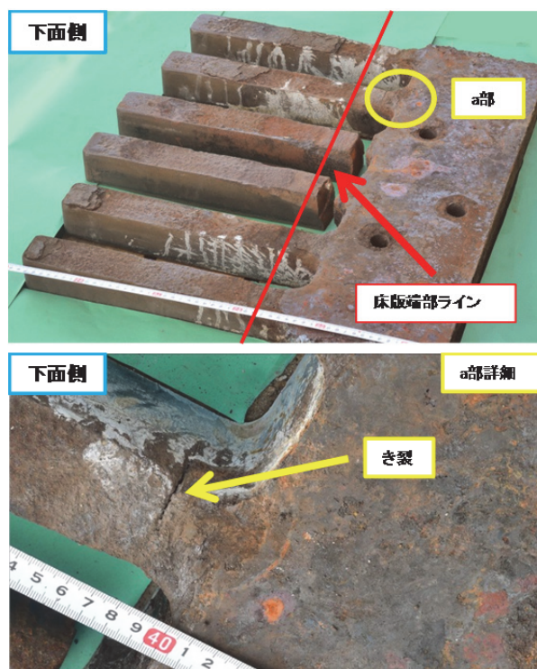
図-3 伸縮装置下面の破断状況(海 P17)
