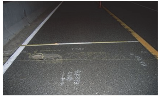
写真-1 損傷状況
