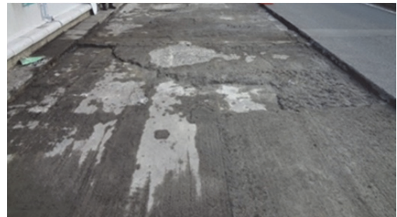
写真-2 床版面不陸
