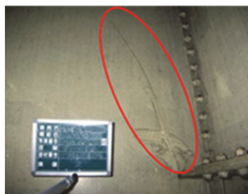
写真-1 他団体での主桁に発生した疲労き裂事例
