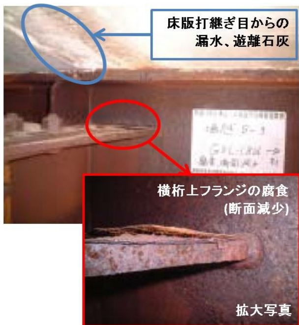
写真-1 堀越川高架橋の損傷状況
