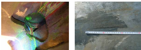
図-3 デッキ貫通亀裂 (左：下面より 右：上面より)
