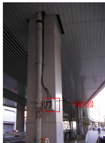
写真-3 中継器設置箇所
