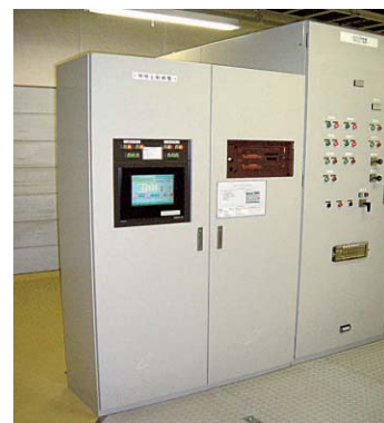
写真-4 照明主制御盤
