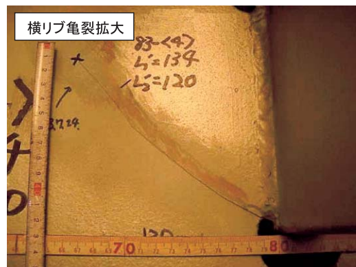
写真-1 亀裂損傷状況
