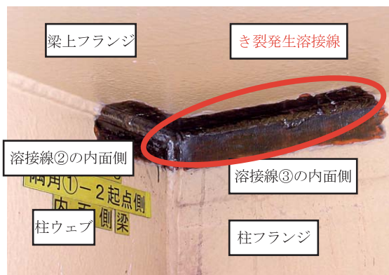
写真-4 橋脚内面き裂発生位置
