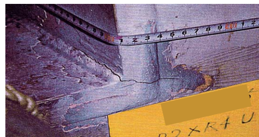
写真-1 角梁FF隅角部におけるき裂状況例
