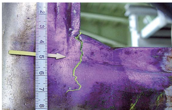
写真-2 3溶接線交差部柱ウェブ側き裂発生状況
