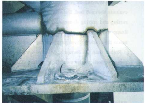
写真-1 実橋での損傷例
