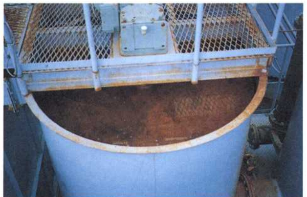
写真-3 造粒槽でのフロック
