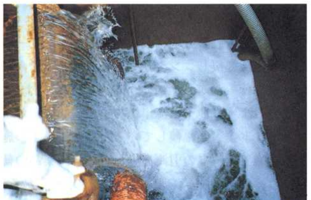
写真-4 放流槽での処理水
