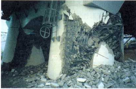
写真-1 神P688橋脚の損傷状況
