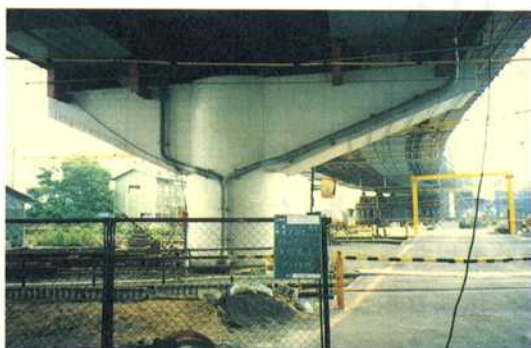
写真-4 暫定用橋軸方向ストッパー
