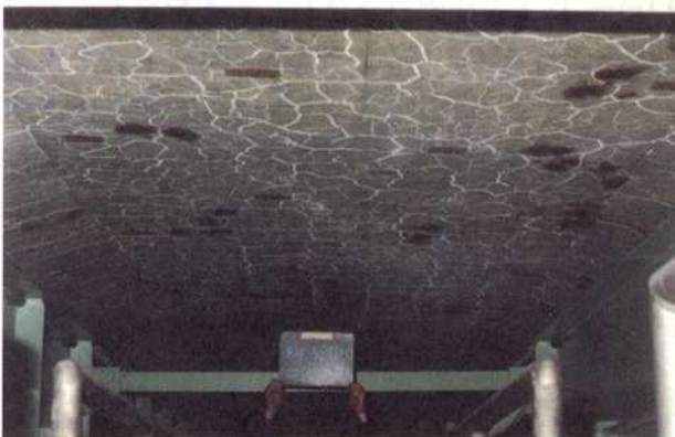
写真-1 ひびわれ状況 (松S-584 A-6) (ひびわれ密度 21.3m/m 2 )
