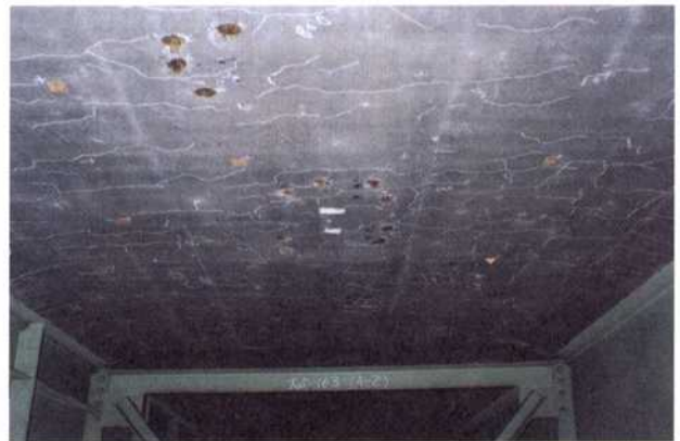
写真-2 活荷重によるひびわれ状況の代表例
