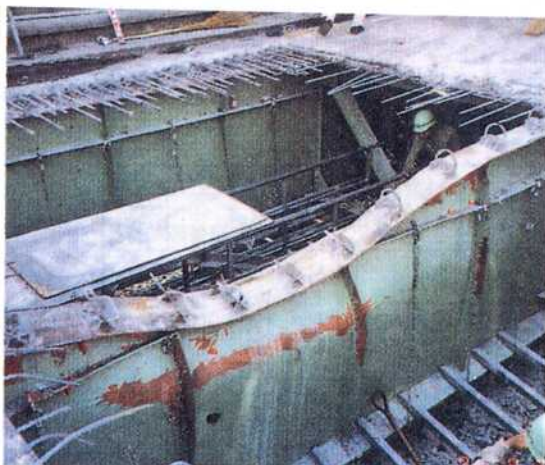
写真-2 主桁の損傷状況
