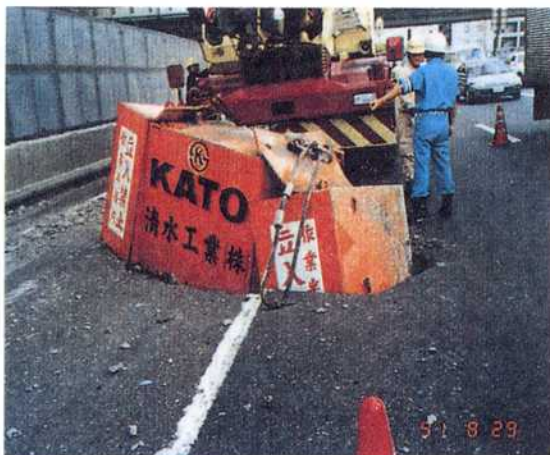
写真-1 事故の現場状況
