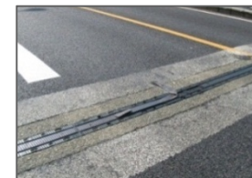
ゴムジョイントの損傷事例 (鋼鉄の露出、段差の発生)
